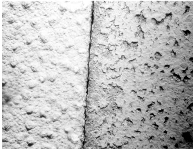
Figur 10: System B18 (flammesprøytet Zn med ett strøk KK). Prøvene er fra Tananger (til venstre) og Borregaard etter ca. 24 års eksponering (forstørrelse 6,4 x). Pga de tynne malingsjiktene vil Zn-oksider fra underlaget presse seg gjennom og danne blærer som etter hvert sprekker. I sur atmosfære som på Borregaard vil imidlertid oksidene vaskes mer eller mindre ut slik at man får groper (pittings). Nær sjø som på Tananger skjer ikke dette. Oksidene løses lite, malingsjiktet blir presset bort, og man får en ruglet overflate bestående av oksider, havsalter og eventuelt rester av et erodert toppstrøk.
