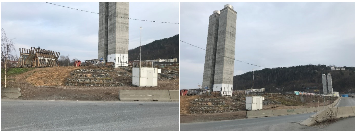
Figur 2: Målestasjon (A) Losæter, rett ved Losæter parsellhagene og bakehus. Venstre: Utsikt mot øst-nordøst. Høyre: Utsikt mot sør-sørøst. Mellom ventilasjonstårnene til E18 Operatunnelen ligger dagsonen på ca. 110 m. Målestasjonen har en 6 m meteorologisk mast for å måle lokale vindforhold. I 2016-2017 var en målestasjon plassert samme sted.
