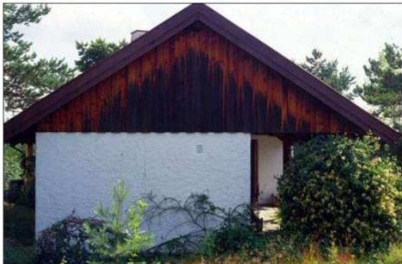
Svertesopp kan virke skjemmende på husfasader. Soppen vokser her i overflatebehandlingen hvor linolje utgjør et godt næringsgrunnlag. Svertesopp tolererer mye UV-stråling, ekstreme temperaturer og uttørring i flere måneder.
