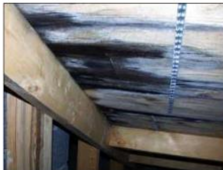
Misfarging av innvendig takbord forårsaket av fargeskadesopp.
