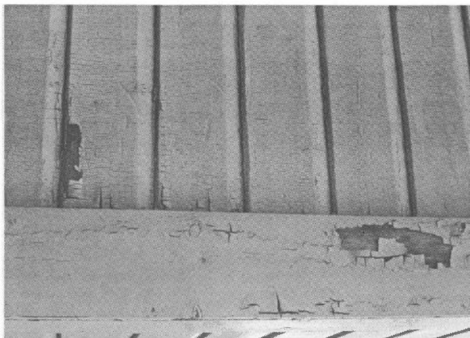
Foto nr. 8: Eksempel på nedbryting av malt treflate.
