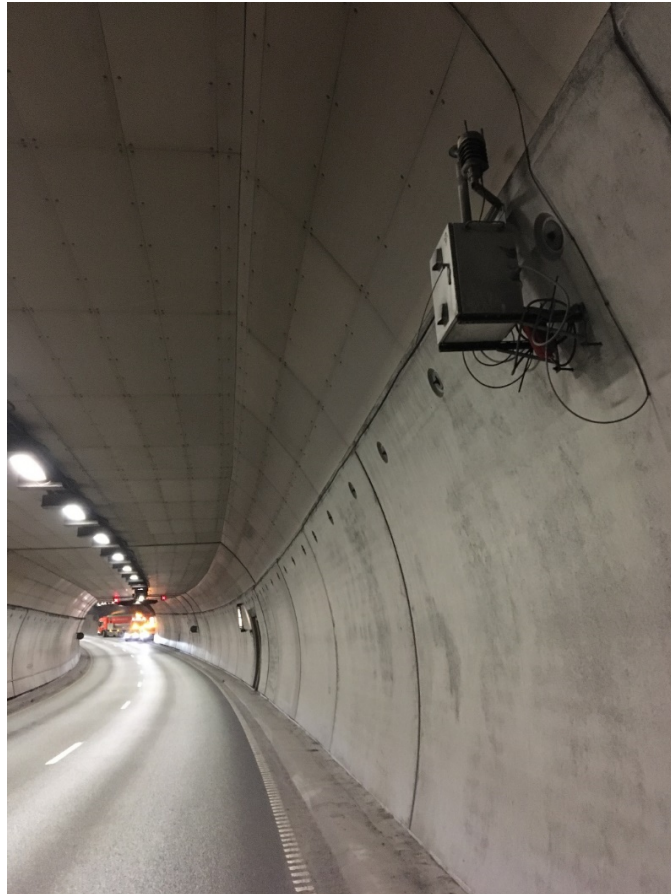
Figur 15: TSI-instrument sammen med Vaisala 2D-vindsensor montert i tunnelveggen (Ekeberg østgående). Foto: Anne-Cathrine Nilsen
